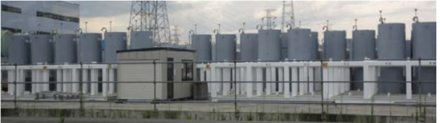
立ち並ぶ約960基の巨大タンク。110万トン超の汚染水を保管し、さらに2020年末までに137万トン分のタンクを確保する計画だが、22年にはタンクの容量が限界に達する
